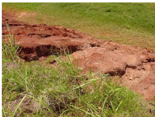
FIGURA 213-III- DETALHE DE PROCESSO EROSIVO NO TALUDE DO ATERRO DA RODOVIA.
