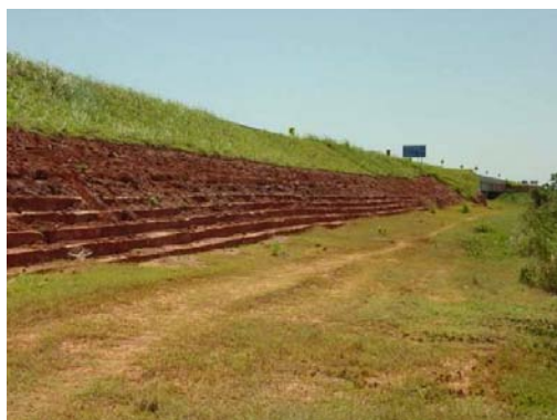
FIGURA 180-III- TALUDE DO ATERRO DA RODOVIA, MOSTRANDO A SUSCETIBILIDADE A ACIDENTES COM CARGAS TÓXICAS.
