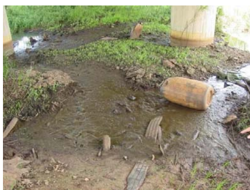
FIGURA 179-III- LIXO ACUMULADO SOB A PONTE SOBRE A LAGOA JACARÉ, NA RODOVIA QUE CRUZA O PARQUE NACIONAL DE ILHA GRANDE.
